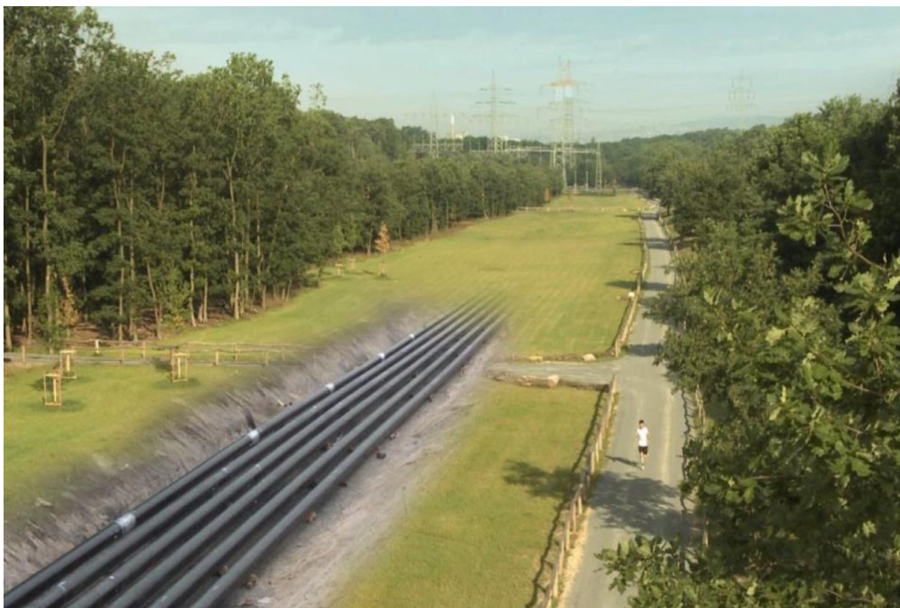
Figur 19 To 400 kV GIL-anlæg nedgravet direkte i Kelsterbach (foto: Siemens).
